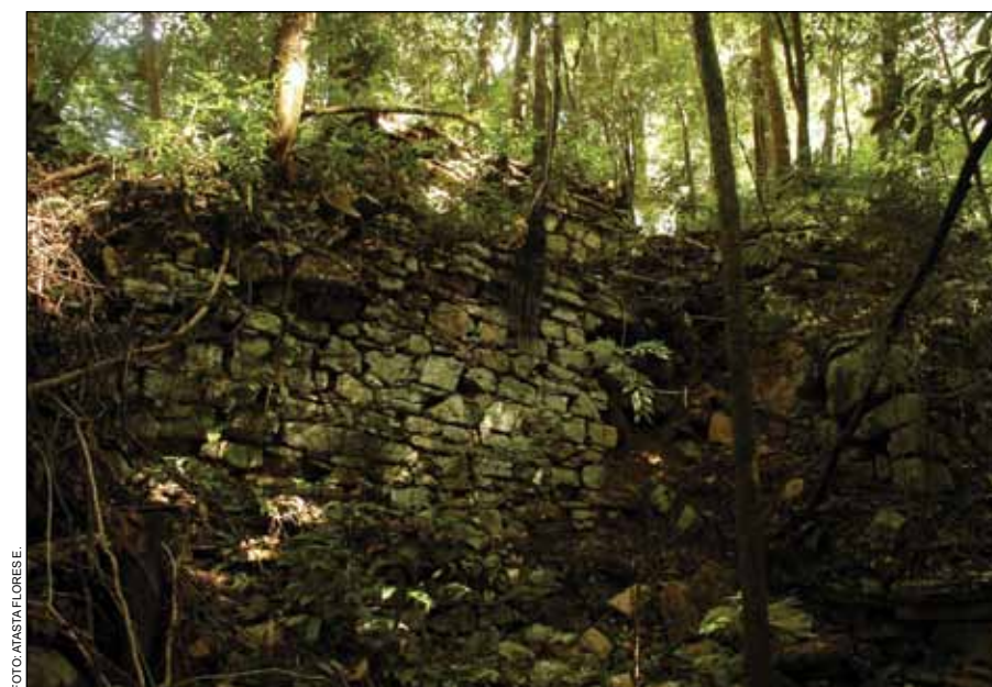
El estado de conservación del Edificio Maler es precario, por lo que su restauración es urgente. Edificio Maler, fachada posterior.
